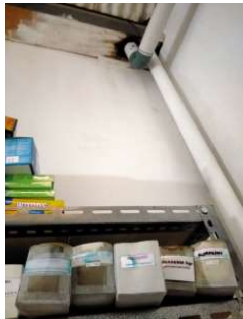
Terdapat atap yang bocor
