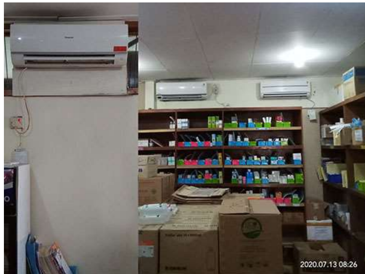
Gambar 5 AC Split. Ruangan bagian depan.* Ruangan bagian belakang.**
